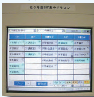
空調機集中リモコン
